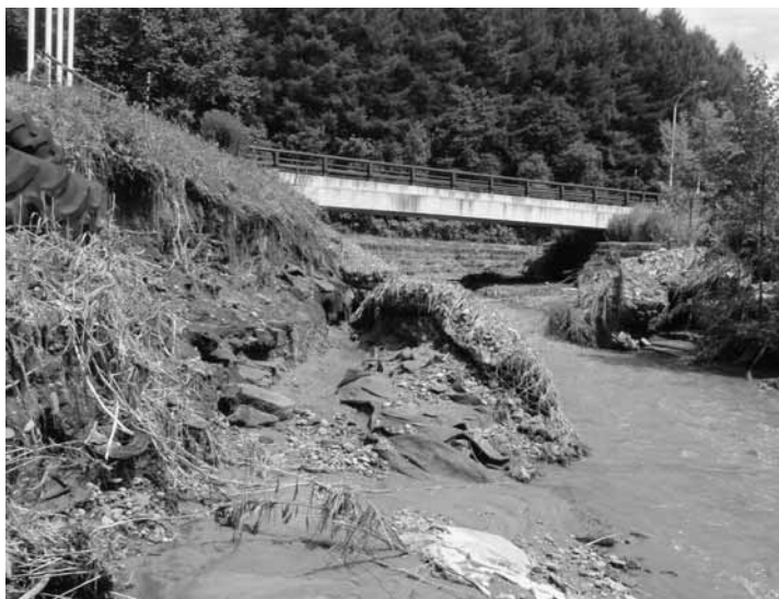
恒久的な河川改修が必要なピリカ富良野川
