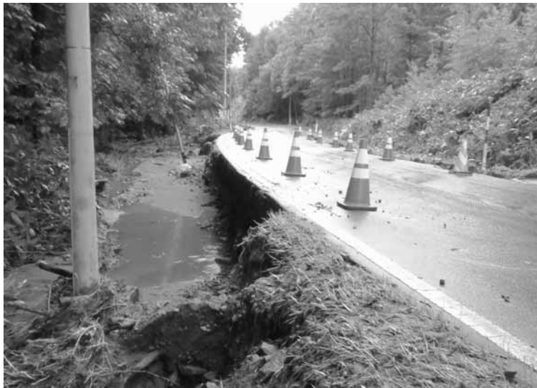
集中豪雨により洗掘した本流の沢道路
